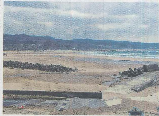
地盤隆起で陸化し消波ブロックが砂に埋もれている（輪島市門前町、3月17日撮影）
